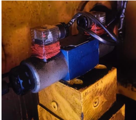
Gambar 9. Solenoid Valve Sumber: Dokumentasi Pribadi (2024)
