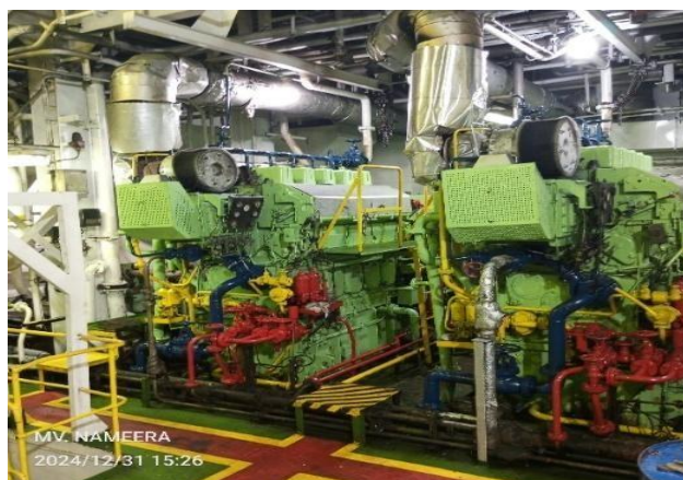
Gambar 1. Generator Diesel Engine Sumber : Dokumentasi Penulis
