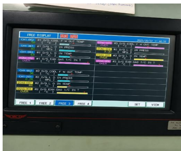
Gambar 2. Generator Monitor Display Sumber : Dokumentasi Penulis
