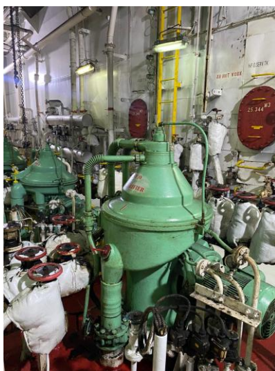
Gambar 1. Purifier Fuel Oil Sumber : Dokumentasi Pribadi
