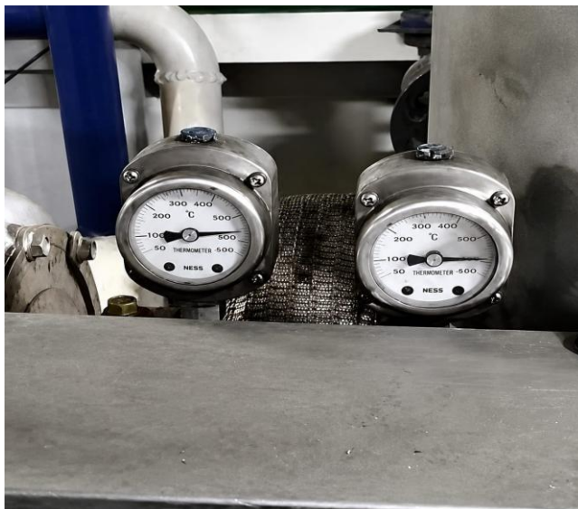
Gambar 3. Indikasi temperatur gas buang pada kondisi tidak normal Sumber: Dokumentasi penelitian di TB Nisrina Riski Samudra VII
