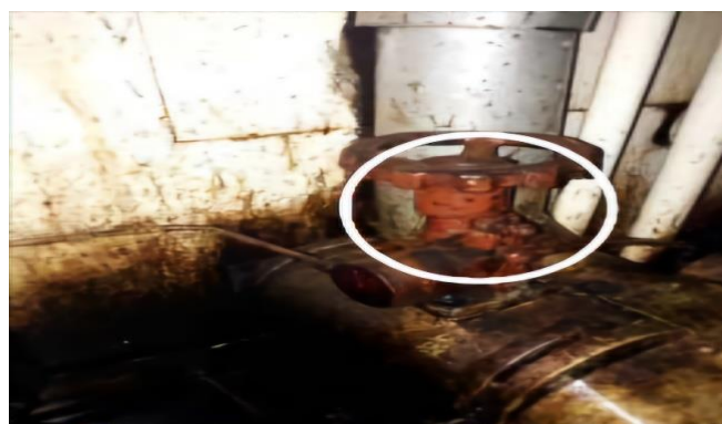
Gambar 3. Adanya tumpukan kotoran dan korosi yang menempel pada valve Sumber: Dokumen pribadi
