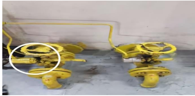
Gambar 4. Pneumatic quick closing valve terdapat lapisan cat Sumber: Dokumen pribadi
